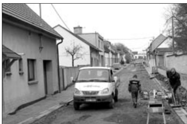
V dolní části Kosmovy ulice byly vydlážděny chodníky, nyní se pracuje na stavbě komunikace. Foto: Milan Kubiček
