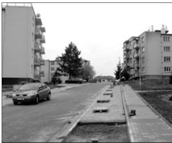
Rekonstrukce sídliště Kopánky vstoupila do druhé poloviny. V horní části obytné zóny byly dokončeny komunikace, parkoviště a chodníky. Foto: MK
