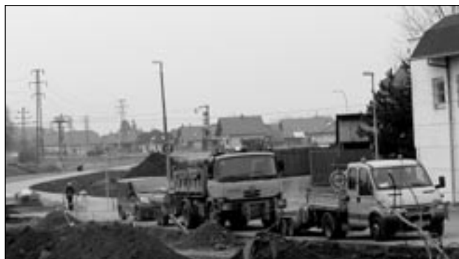
Pilně se pracovalo při dokončení výstavby komunikace, cyklostezky a chodníků ve směru od Zerzavice k Trávníku. Foto: Milan Kubiček
