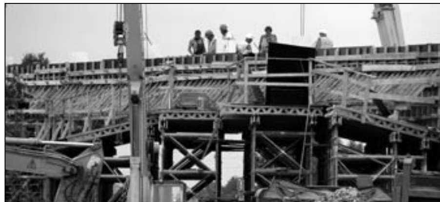
Čilý stavební ruch na mostě v traťovém úseku Staré Město u Uh. Hrad. – Kunovice.
