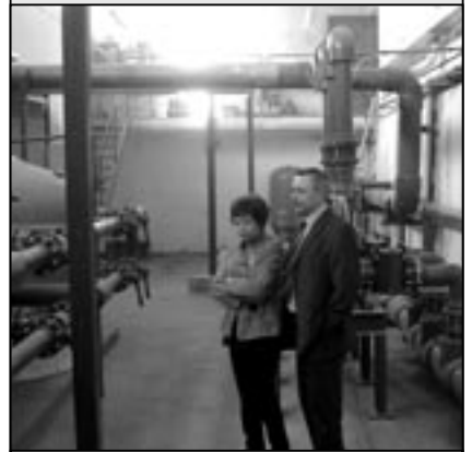
Starosta Josef Bazala a vedoucí odboru správy majetku a životního prostředí Ing. Markéta Hrušková ve strojově koupaliště, kde byla instalována moderní technologie. Foto: MK
