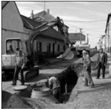
V Metodějově ulici se pilně pracovalo na rekonstrukci kanalizace. Snímek je z 5. června 2009.
