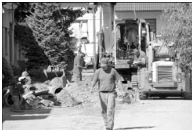
Stavební ruch zavládl v Máchově ulici, kde se bude provádět rekonstrukce komunikace a chodníků.
