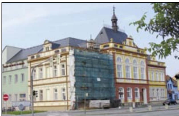
Levá část budovy radnice je nyní zakryta lešením a plachtou. Do začátku Michalských slavností budou práce na opravě přední části fasády radnice dokončeny. Foto: Milan Kubíček
