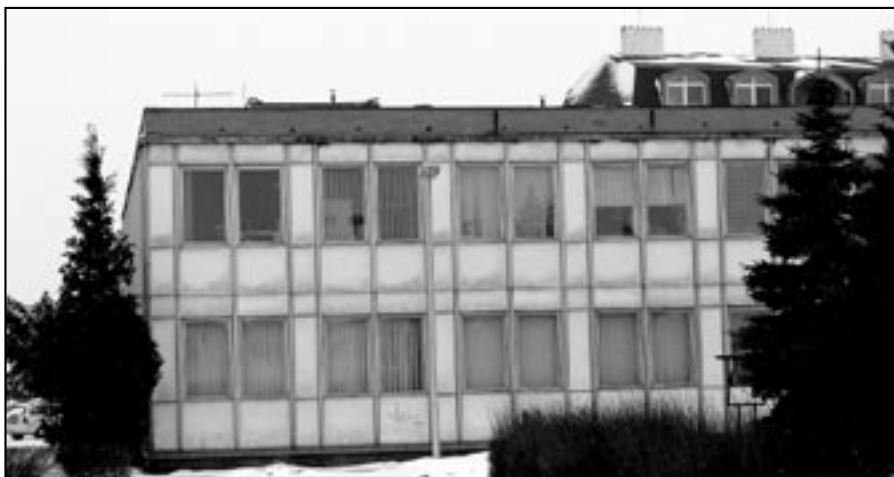
Hlavní budova zdravotního střediska, ve které jsou umístěny ordinace praktických lékařů, stomatologů a je zde lékárna. Ze stávajících panelů budou odstraněny venkovní skleněné fasádní desky a vyplně otvorů oken a dveří. Střechy budou zatepleny polystyrenem. Foto: Milan Kubíček
