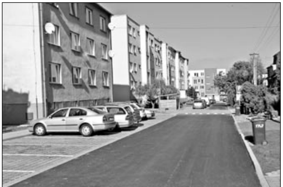
Po dokončení je rekonstrukce Alšovy ulice. Na 192 metrů dlouhé vozovce je nyní živичný povrch, byla položena zámková dlažba na chodníku o délce 200 metrů a šířce 1,5 metru a dále bylo vybudováno 39 parkovacích míst. Foto: Milan Kubíček
