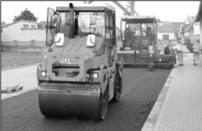
Spodní vrstva živičného povrchu byla položena 8. listopadu, druhá pak o den později. Na snímku vlevo část parkoviště s 18 místy. Foto: MK
