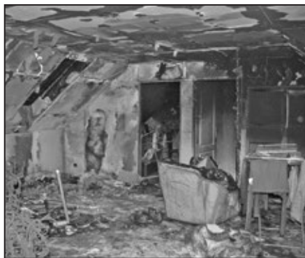
Oheň zasáhl podkroví a střechu rodinného domu na Brněnské ulici.
