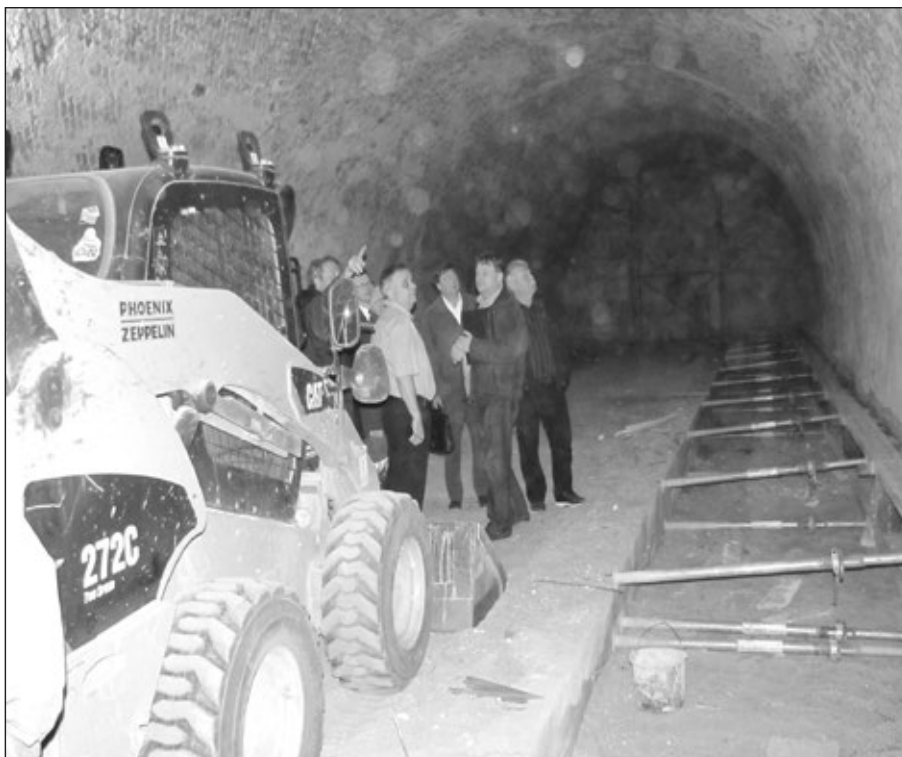
Pracuje se na dokončení stavebních úprav Jezuitského sklepa, který se nachází pod kostelem sv. Ducha.
