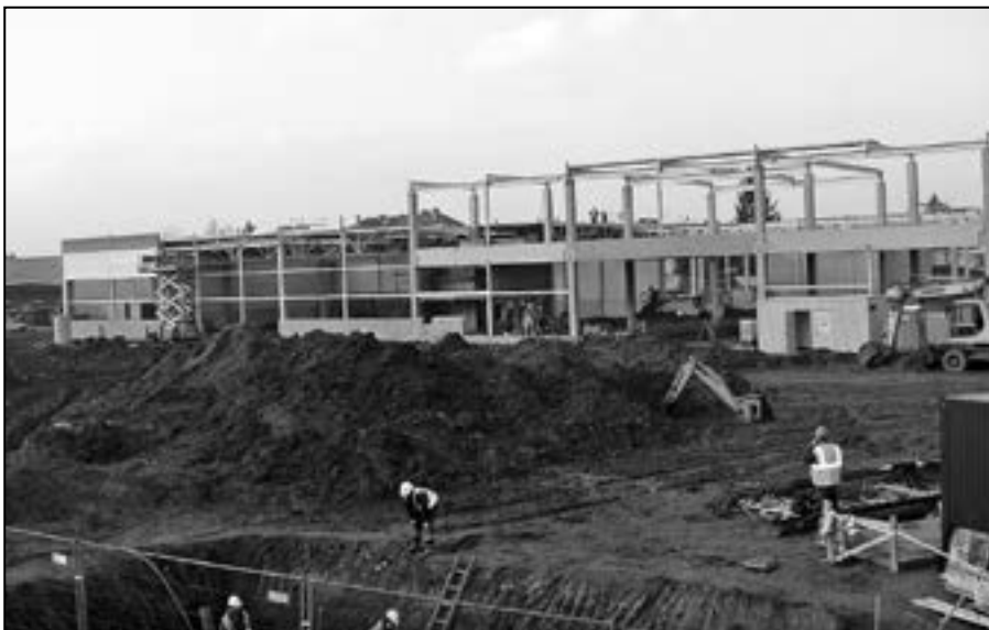
Velmi rychlým tempem pokračuje výstavba marketu UNI HOBBY v blízkosti Intersparu. Snímek je z 25. února 2014.
