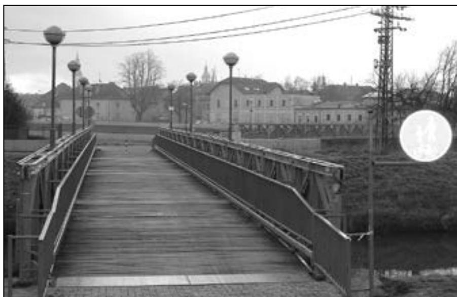
V plánu investic našeho města na letošní rok je také oprava pochůzných ploch lávky přes Bařův kanál.
