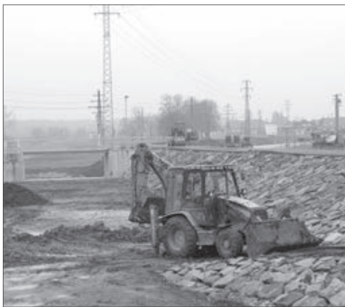
Dokončovací práce na stavbě lávky přes suchý poldr u Baťova kanálu dne 13. listopadu. Foto: Milan Kubíček
